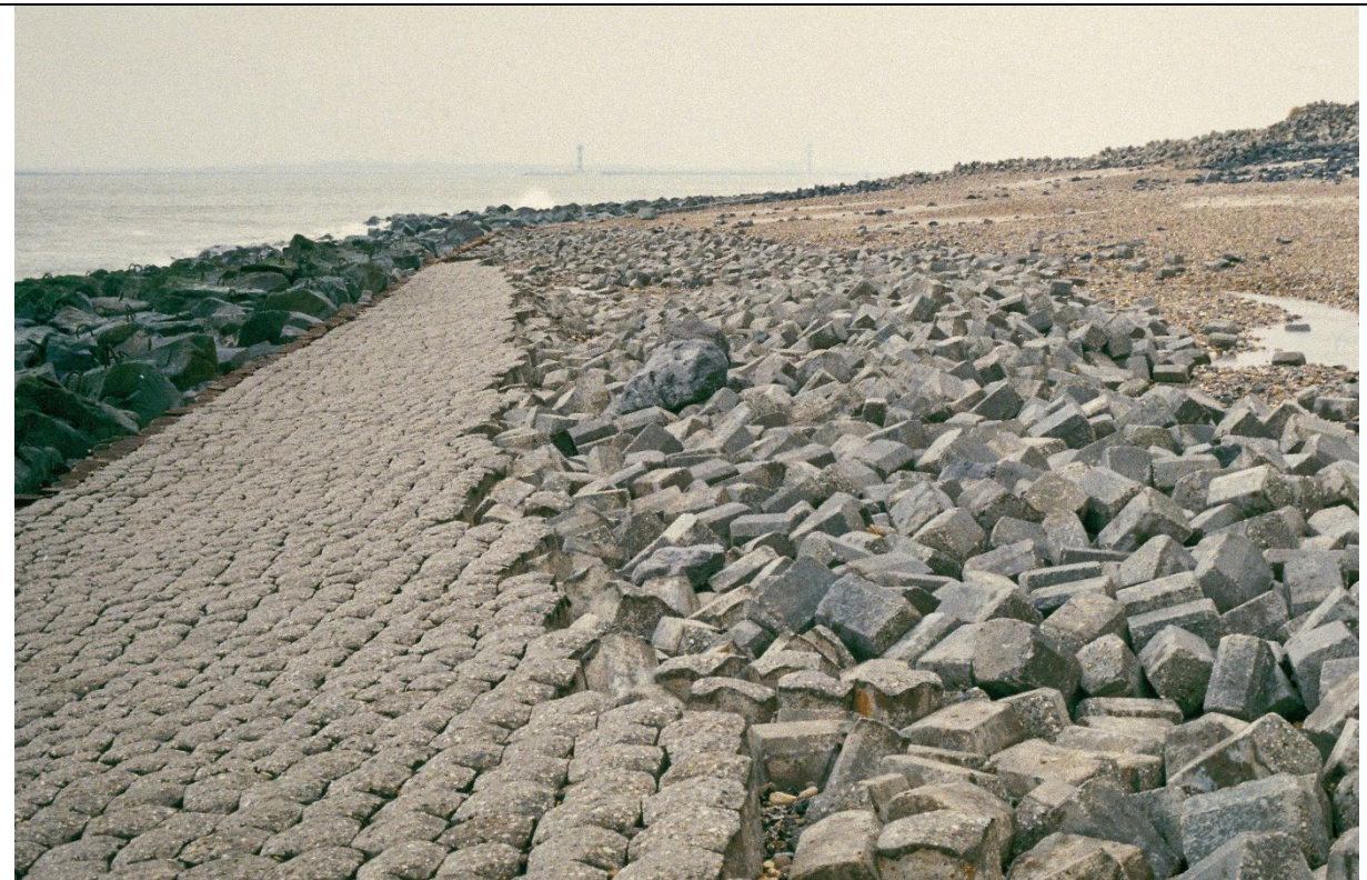
Schade aan de Basaltonglooiing bij de Zuidwal in 1988
